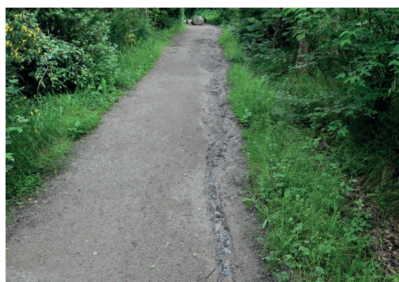
Figure 12. La réfection de nids de poule sur un chemin au gour de Tazenat. (V.Bayeron, juin 2018)
