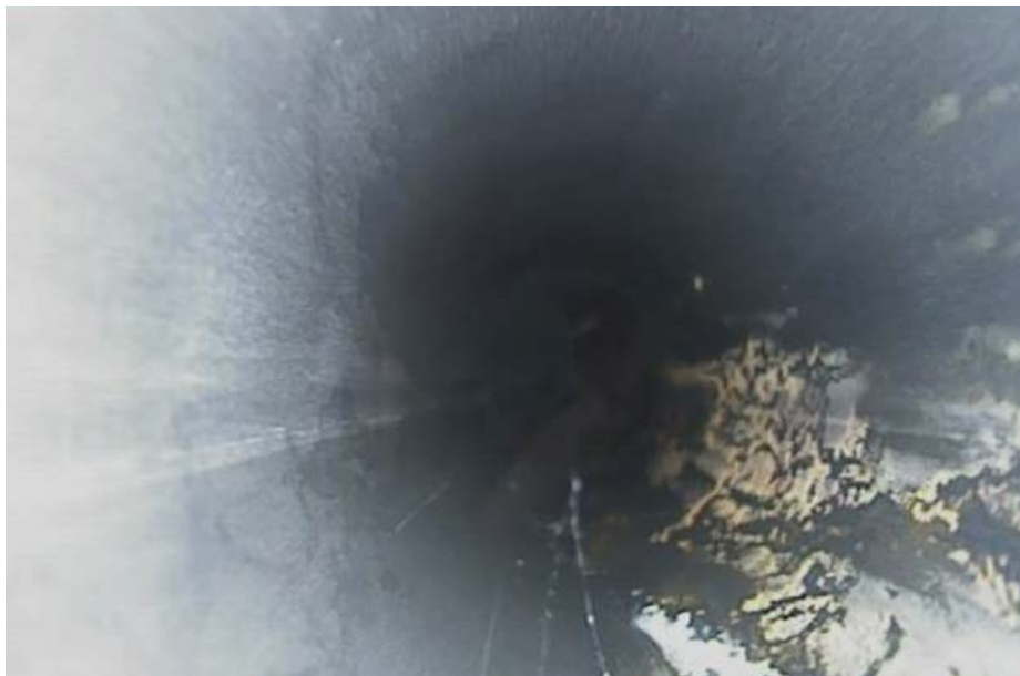
Figure 54: Photo de l'intérieur d'un tuyau présentant des résidus de poudre
