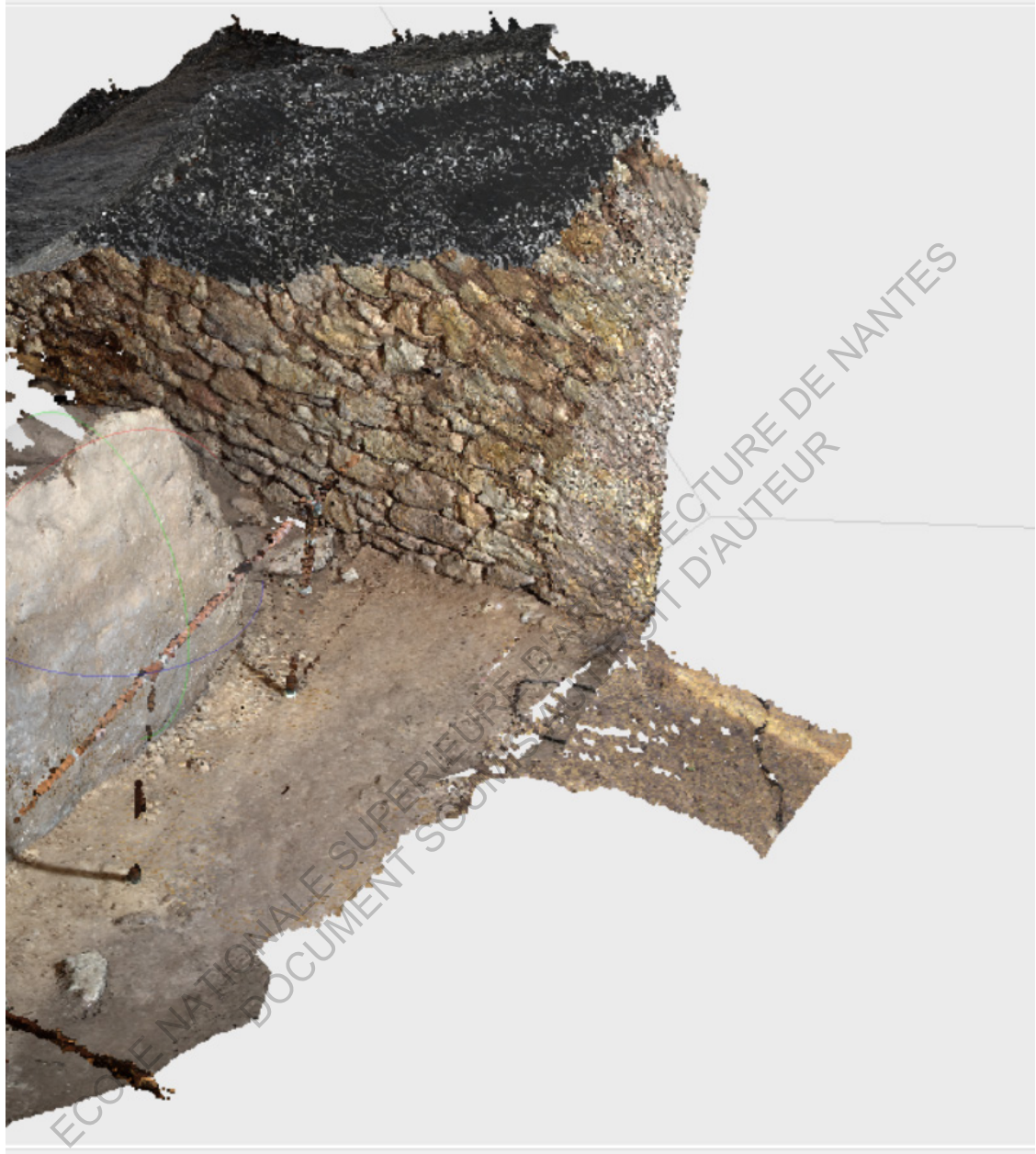
(fig 5) Nuage de points de la face avant, paroi arrière, angle et environnement proche
