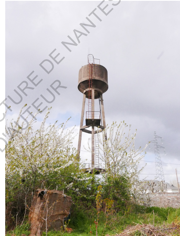
Le réservoir du Jardin des Ronces, condamné.
