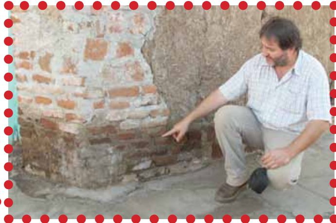
Figure 149- Infiltration d'eau dans la base du mur due au recouvrement du sol par du macadam et à l'absence d'une coupure de capillarité. L'eau ne pouvant s'évaporer ressort par le mur. Soubassement insuffisant, la structure en terre est dégradée (Source : photographie personnelle)
