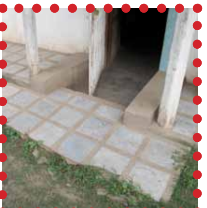
Figure 153- Problème de conception: le niveau du sol de l'habitation est plus bas que le terrain naturel. Risques d'inondation (Source : photographie personnelle)
