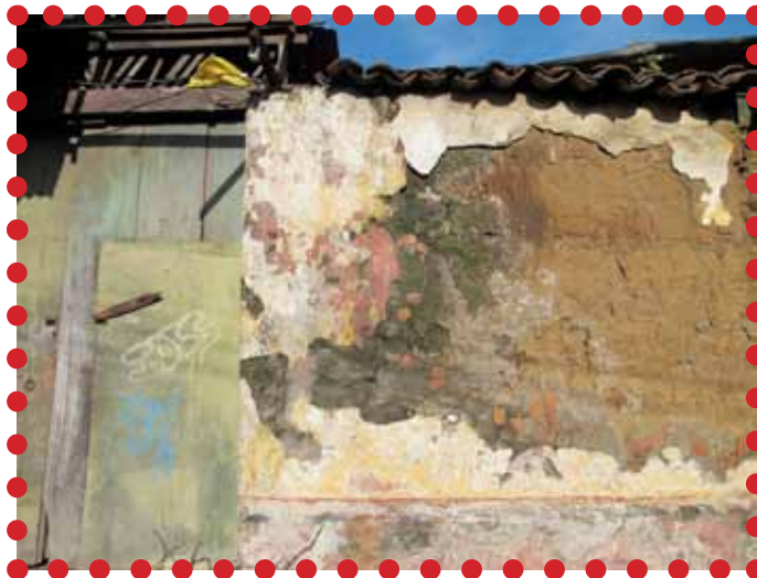
Figure 145- Infiltration d'eau de pluie et dégradation en raison d'une mauvaise protection de la tête de mur (Source : photographie personnelle)
