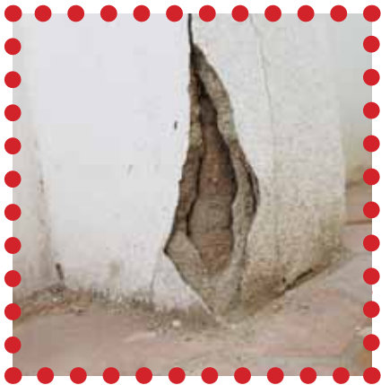
Figure 151- Infiltration d'eau par capillarité dans la base du mur qui est enduit au ciment. L'eau ne pouvant s'évaporer finit par le décoller (Source : photographie personnelle)
