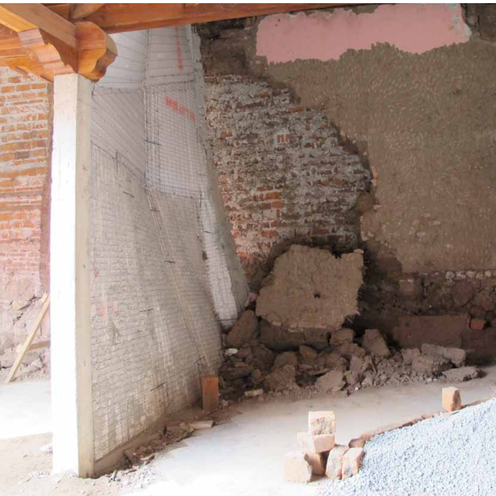
Figure 136- Adobe VS Covintec, la vengeance de l'adobe sera terrible (Source : Photographie personnelle)
