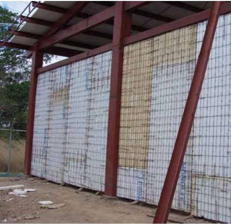
Figure 54- Exemple de construction en Electromalla (Source : La nueva cartilla de construcción , MTI, p. 161)
