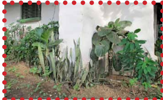
Figure 154- Plantes trop proches des murs : risques d'accumulation et d'infiltration d'eau ainsi que de dégradation en raison des racines (Source : photographie personnelle)
