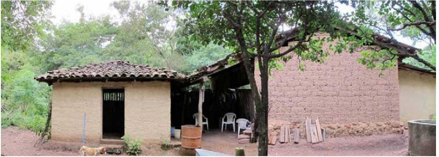
Figure 170- Maison en adobe « actuelle » d’Elia Perez Lopez (construite par son père il y a plus de cinquante ans), Sabana Grande (Nueva Segovia). Inondée et touchée de plein fouet par l’ouragan Mitch en 1998 elle n’a subi aucun dégat (Source : photographie personnelle)
