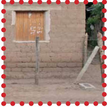
Figure 152- Aucun soubassement ne protège l'assise de la maison (Source : photographie personnelle)
