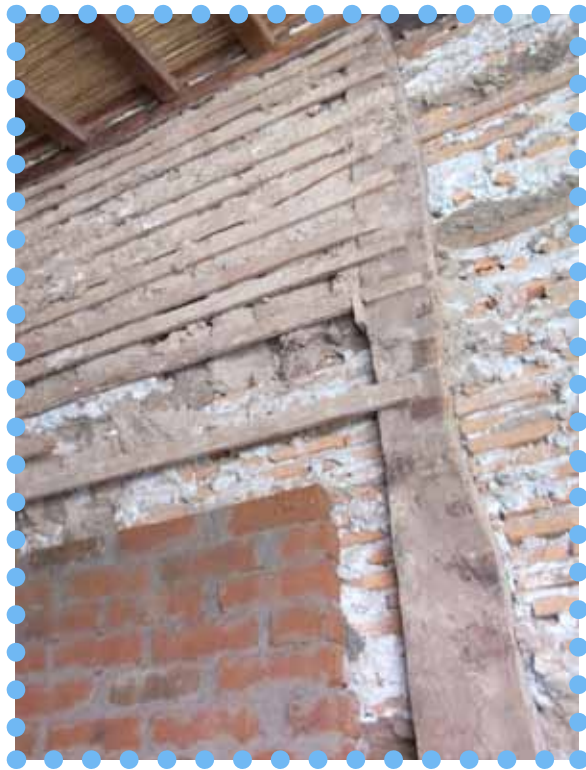
Figure 156- Structure de taquezal en restauration. Elle conservera son intégrité et son comportement dynamique lors des séismes (Source : photographie personnelle)
