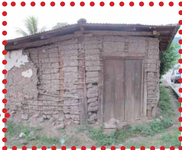
Figure 150- Aucune coupure de capillarité, aucun soubassement. Détérioration rapide de l'ossature et du remplissage (Source : photographie personnelle)
