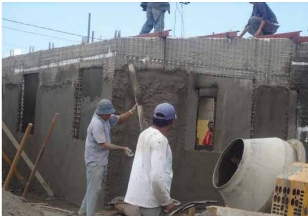
Figure 58- Pose de l'enduit en ciment sur de l'Electromalla (Source : La nueva cartilla de construcción , MTI, p. 162)
