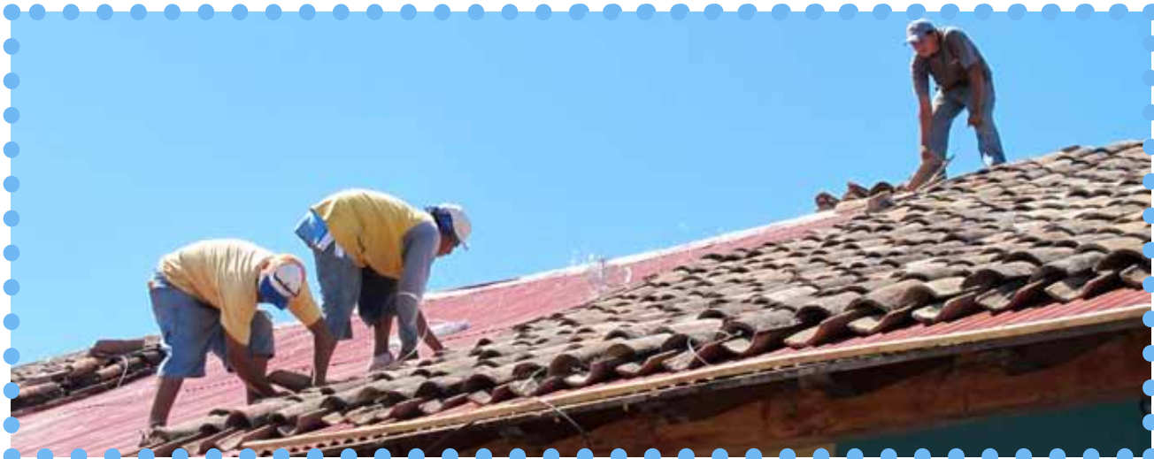
Figure 143- Innovation incrémentale provenant du contournement d'un problème de matériau; lui-même issu d'une raréfaction de ressource: la pose d'une double couverture zinc-tuiles, Granada (Source : photographie personnelle)
