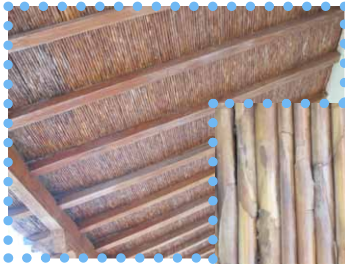
Figure 127- Structure dense de la toiture pour reprendre la forte charge des tuiles tout en pouvant y incorporer des sections courtes (plus résistantes) de canne (Source : photographie personnelle)
