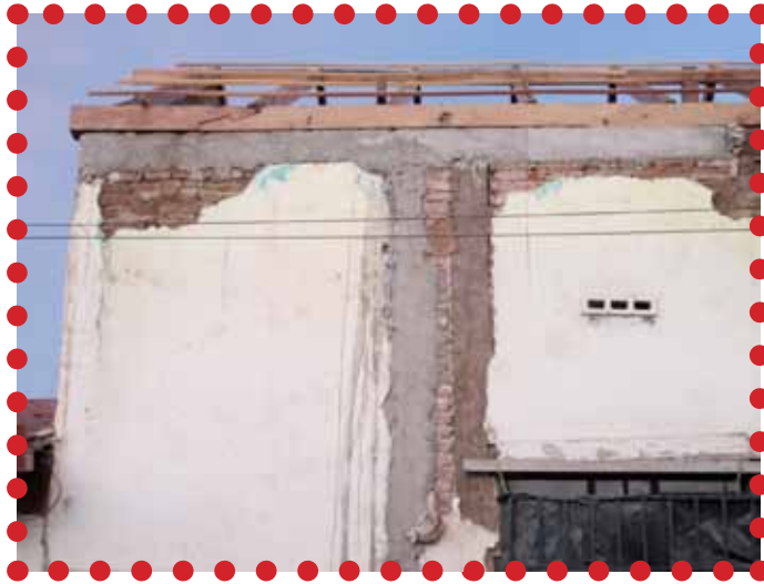
Figure 158- Insertion de portions de structures en béton armé dans un édifice en taquezal . Comportement dynamique de la structure amoindri et résistance face aux séisme menacé. Pérennité diminuée, vulnérabilité augmentée (Source : photographie personnelle)
