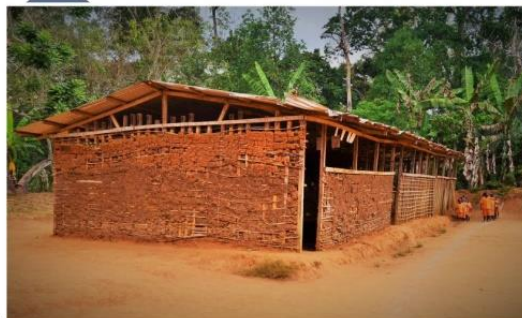
Salles de classe -EPP - Ntang / Cameroun Torchis / Terre battue. Source : Mauricio Corba
