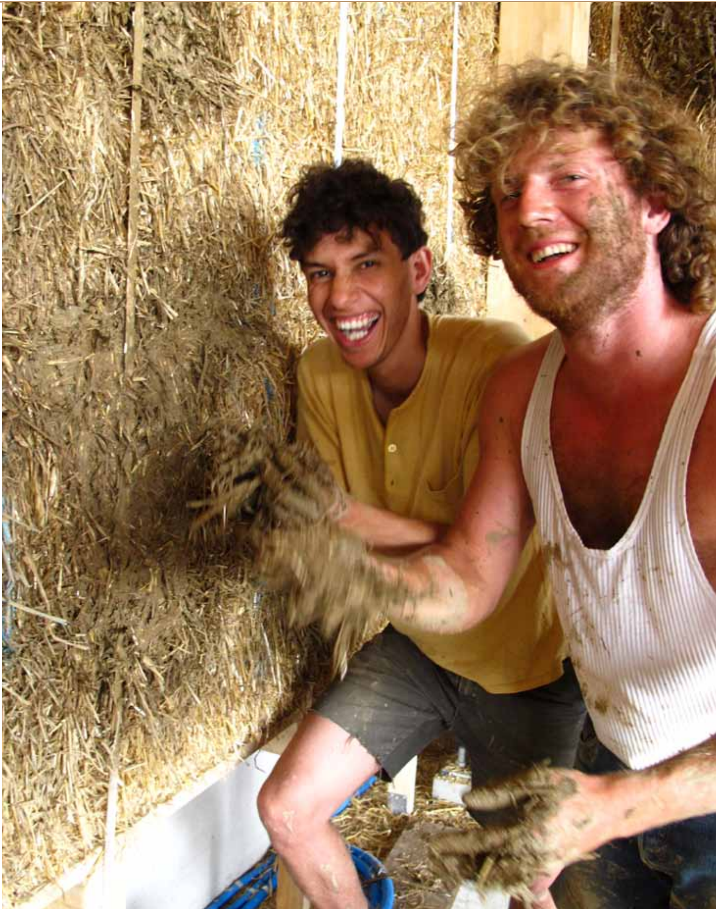
Photos: Rébouchage des murs avec la terre-paille, aussi un moment de convivialité sur le chantier. Genève. Suisse. Source: Photo personnelle
