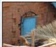
Briques et mortiers trop lourds Pudaenior modi is mo
