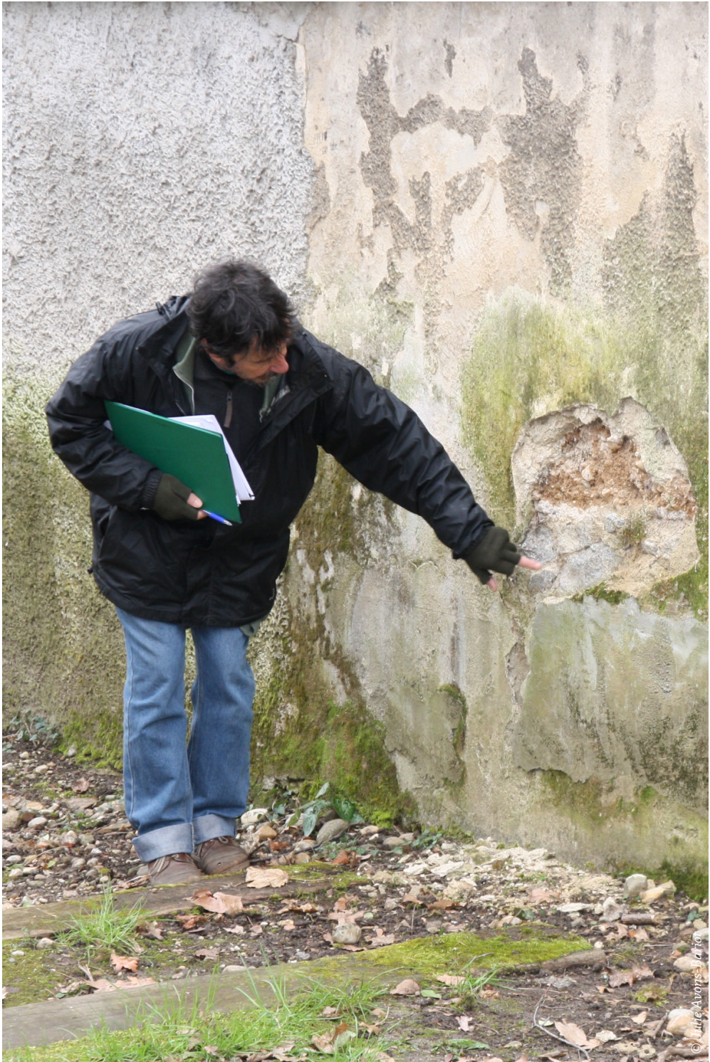
⤴ Diagnostic d'un mur de clôture (1km) en pisé autour d'une résidence - Saint-Genis-Laval (69)
