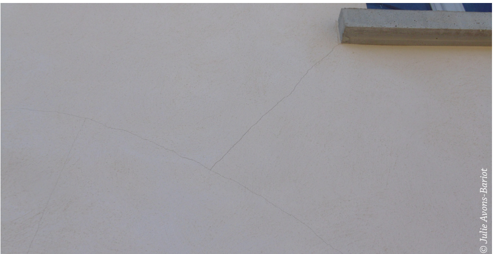
⤴ Détail sur le faïençage de l'enduit
