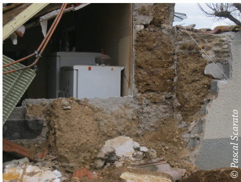
⬆ Présence de parpaings contre le mur de clôture.
