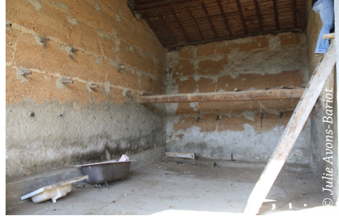
⬆ Mur de refend Sud et mur Ouest rongés par du sel. « Tartinage » d'enduit ciment.
