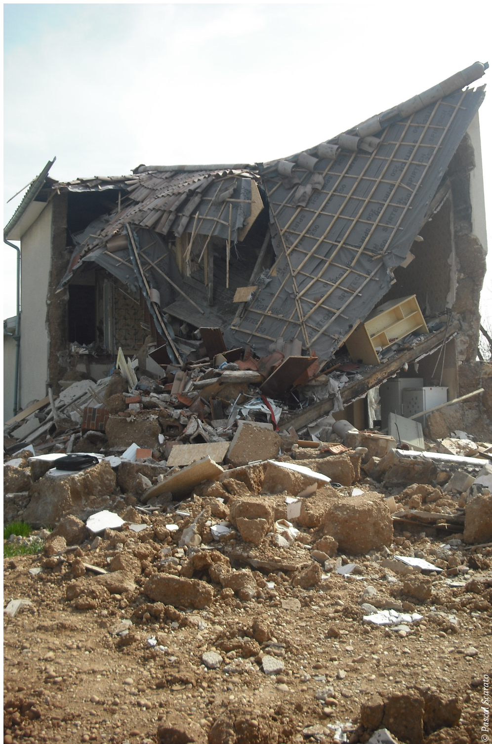
↑ Effondrement de la façade Nord puis Ouest suite piquage enduit - Saint Alban du Rhône (38)
