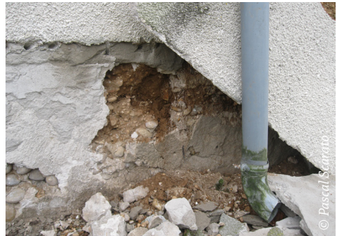
⬆️ Humidité le long de la descente d'eau
