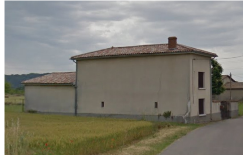
↑ Photographie Google map - juin 2013 De nombreuses fissures sont visibles.
