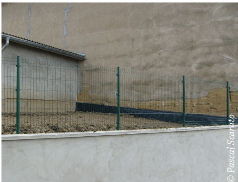
⤴ Mise en place d'un delta MS sur enduit étanche pour tenter de résoudre les problèmes d'humidité
