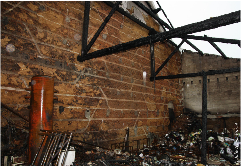
⬆ Incendie dépendance en pisé - Saint Maurice de Gourdans (01)
