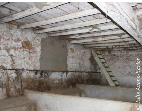
⬆ Présence importante de salpêtre dans la partie agricole
