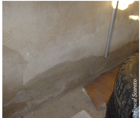
⤴ Traces d'humidité et de sels dans le garage liées à la rehausse
