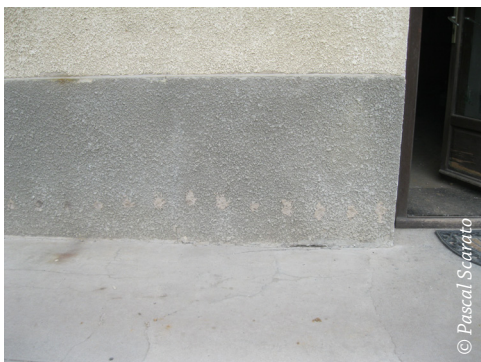
⬆ Traces d'injection de résines dans le soubassement pour «traiter l'humidité».
