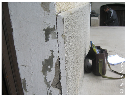
⬆ Décollement de l'enduit en pied de façade Sud.
