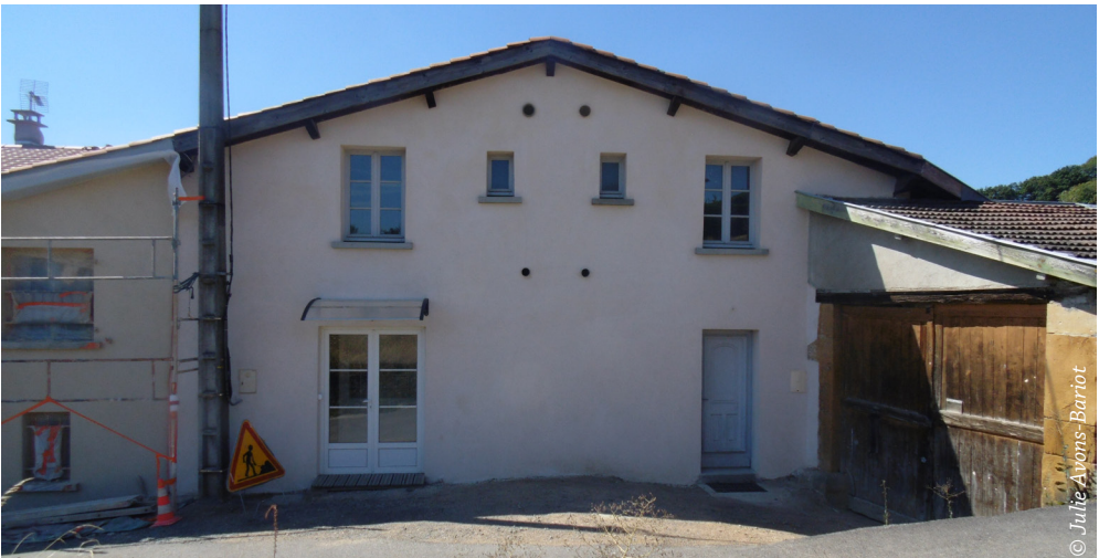
⤴ Façade Nord lors de l'expertise 3 mois après la pause de l'enduit
