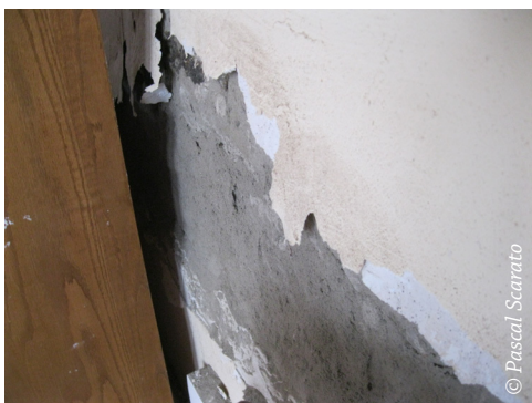
⬆ Présence de sel en pied de mur.
