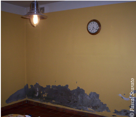
⤴ Dégradation intérieure liée à la rehausse dans la cuisine
