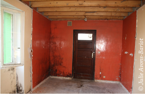
⬆ Diagnostic avant travaux - Humidité intérieure objet initial de la demande
