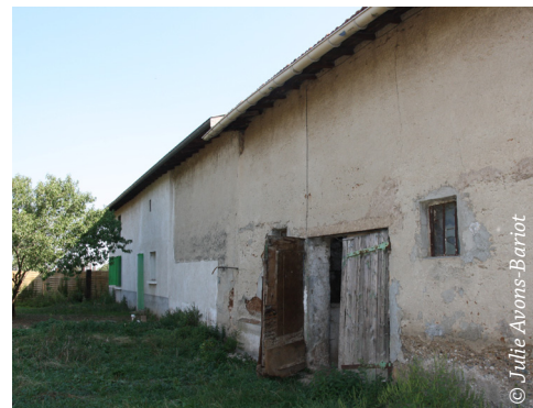
⬆ Mur Ouest : Enduit refait avant la vente. Amène le doute sur l'état du mur.
