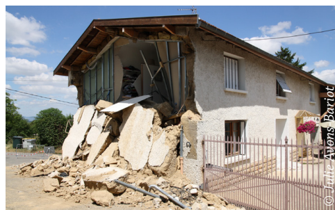
⤴ Expertise privée, effondrement - Saint Pierre de Chandieu (38)
