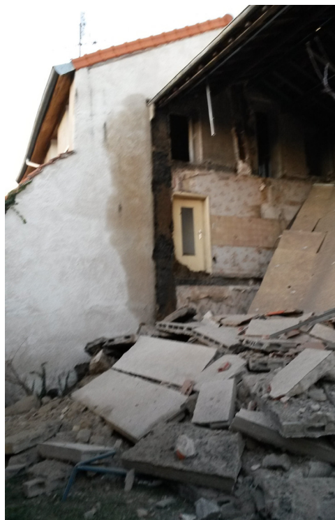
⤴ Photographie de l'effondrement transmise par le propriétaire
