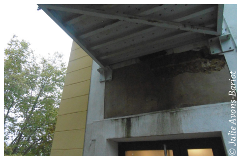
⤴ Expertise judiciaire, suite travaux ascenseur - Cailloux sur fontaine (69)
