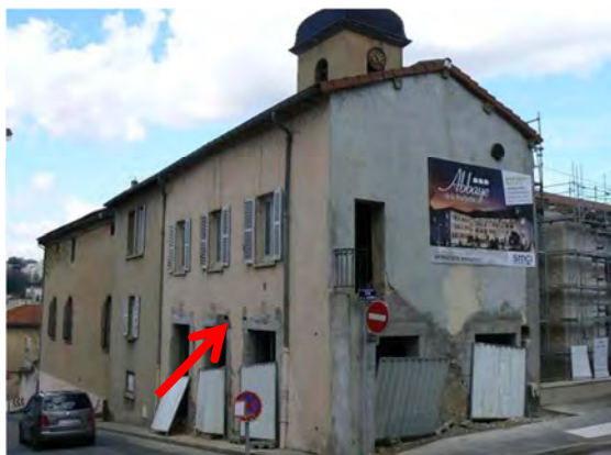
Ancienne abbaye bénédictine de la Rochette, rue Lucien Maître, Caluire-et-Cuire. Les récents travaux de transformation ont révélé la maçonnerie de pisé sur la façade sur rue. Photographie : Emmanuel Mille
