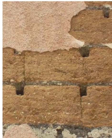
Détail du mur pignon d'un immeuble, maçonnerie en pisé de terre sur lits et soubassement de mâchefer (43 rue Coste, Caluire-et-Cuire, photographie Emmanuel Mille).
