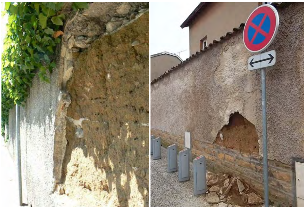
Sinistres sur des murs de clôture, Caluire-et-Cuire, 2015. A gauche (rue de la Gare de Cuire), l'enduit atteint 15 centimètres d'épaisseur. Il a été refait à l'identique au bout de quelques jours. A droite (rue Baudran), l'enduit a été refait à l'identique au bout de quelques semaines. Photo : E. Mille
