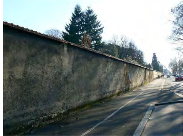
Mur de clôture de l'Hôpital du Vinatier construit par A. Louvier, architecte départemental, à Bron. Photo. : E. Mille.
