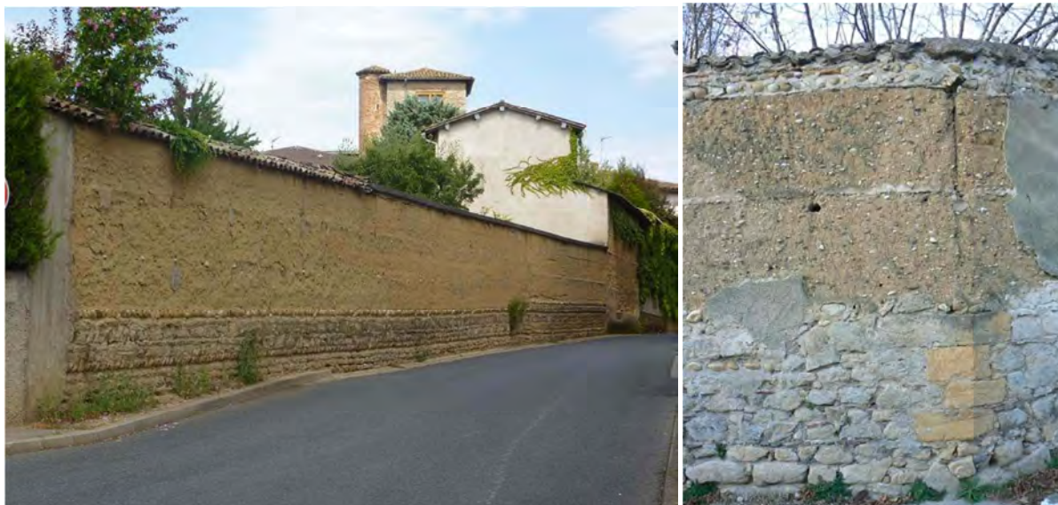
Mur de clôture et communs du château de la Grive, Cailloux-sur-Fontaine. Source : Mur de clôture du Clos de la Haye, Charly. Photo : E. Mille.
