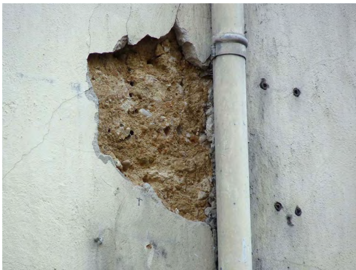
Façade Grande rue de la Croix-Rousse, Lyon 4 e . Une lacune dans l'enduit laisse apparaître le pisé de terre. Photo : S. Moriset, CRATerre.
