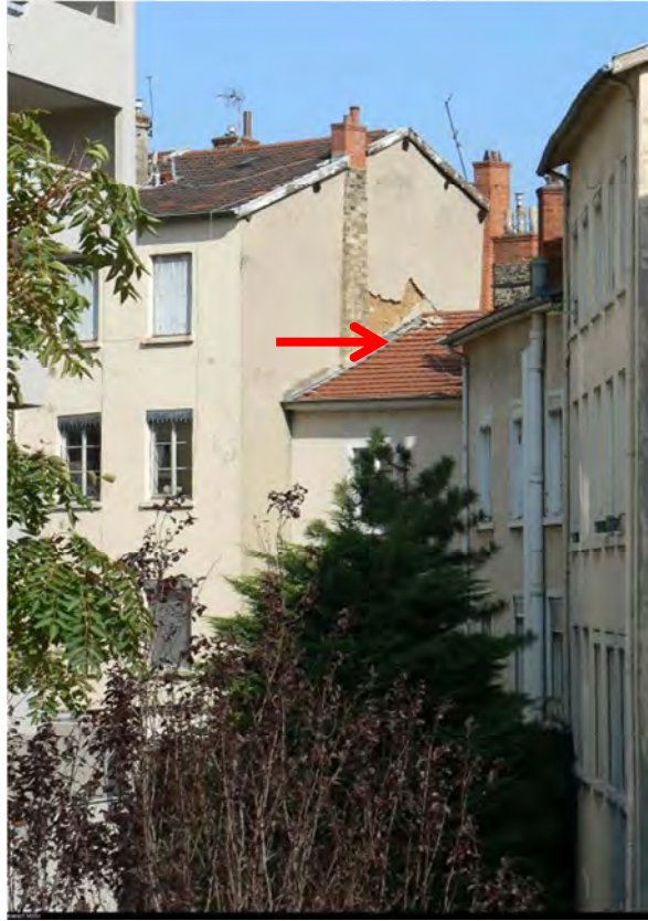
Mur pignon d'un immeuble de 4 niveaux en pisé de terre (rue Mistral, Lyon 3 e ). Photo : E. Mille
