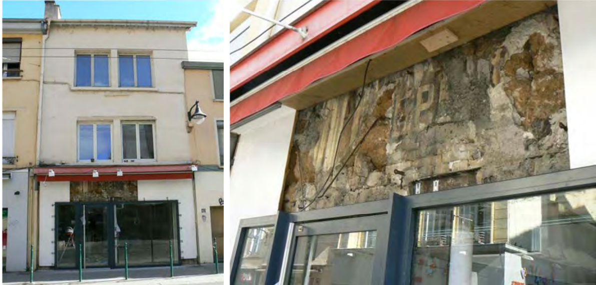
Petit immeuble situé Grande rue de la Croix Rouse (Lyon 4 e ). Le pisé visible lors de la réfection de la devanture. Photo : E. Mille
