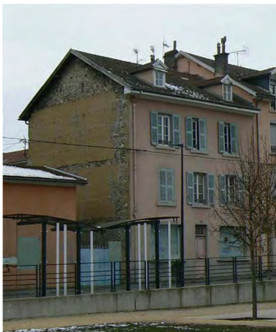
Mur pignon en pisé de terre et moellons de pierre d'un immeuble de Voiron. Photo : E. Mille, 2016.
