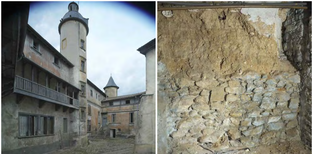
Château de la Motte, Lyon7e (classé MH). Vue de la cour et détail d'une maçonnerie de pisé sur soubassement de pierre. Photographies : Didier Gourbin, Région Auvergne-Rhône-Alpes, Inventaire général du patrimoine culturel.
