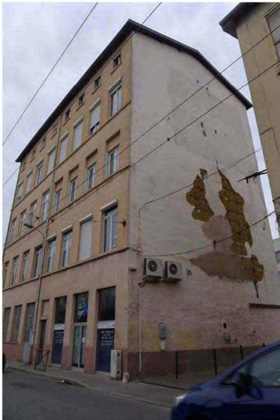
Mur pignon en pisé de l'immeuble situé 43 rue Coste, Caluire-et-Cuire. Photo : A-S. Cléménçon
