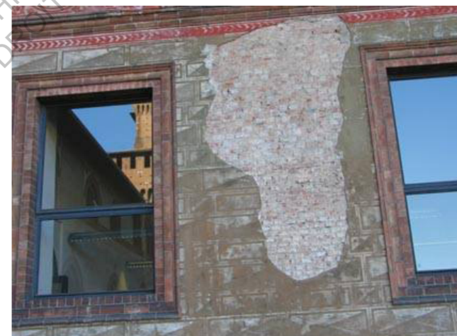
Figure 15 : Archive photographique montrant la dégradation de la façade de l'ancien hôpital espagnol, un siècle après la restauration de Beltrami, en 2003.
