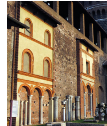
Figure 81 : Archives présentant l'hôtel particulier d'origine datant du XVe siècle et dont les greffes ont été prélevées afin de préserver une partie de la démolition. Greffes mise en au début du XXe siècle lors de la restauration de Beltrami.
