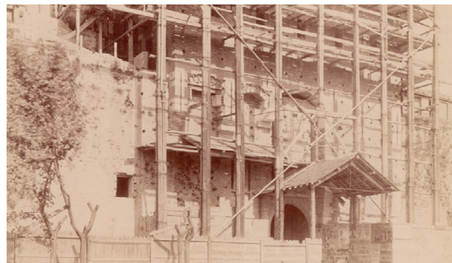
Figure 65 : Archive photographique présentant la mise en place d'échafaudages sur les remparts autour de la place d'armes.
