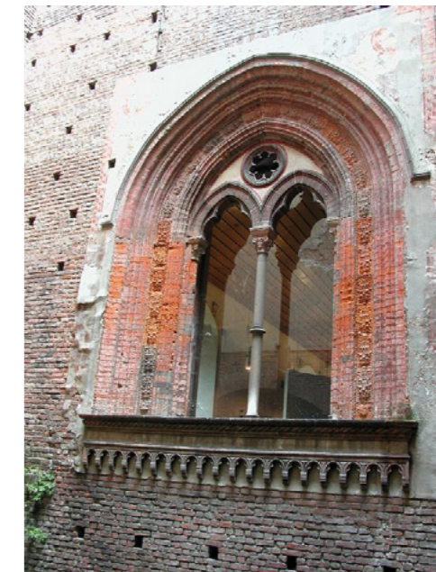
Figure 11 : Fenêtre à une baie avec un ensemble décoratif réalisé en terre cuite et composé d'un poteau en pierre en 2015.
