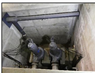
Figure 6 - Pompes de relèvement et conduite de refoulement
