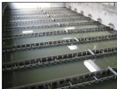
Figure 9 - Photo des décanteurs lamellaires
