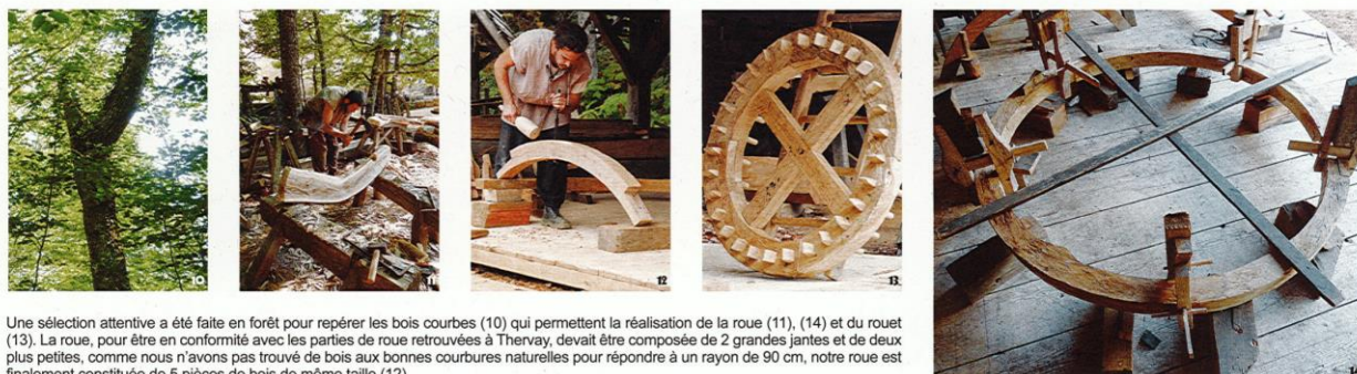
Pierre Mille et Gilles Rollier ont travaillé à l'implantation du bief, au canal d'aménée (7), à la définition de la réserve en eau et à la disposition des vannes (5) pendant que les bûcherons fendaient et taillaient les palplanches du bief en chêne (6). Le terrassement de l'ensemble de l'installation s'est fait manuellement. Un chêne de 3,50 m et de 60 cm de diamètre a été sélectionné en forêt de Guédelon pour fournir la pièce nécessaire au coursier, c'est un bois monoxyle creusé dans sa masse (8) (9).
