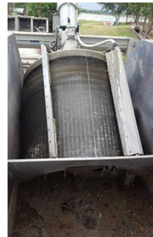
Photo 6 : Dégrillage fin (GITEC, 2018)
