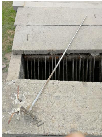
Photo 5 : Dégrillage grossier (GITEC, 2018)
