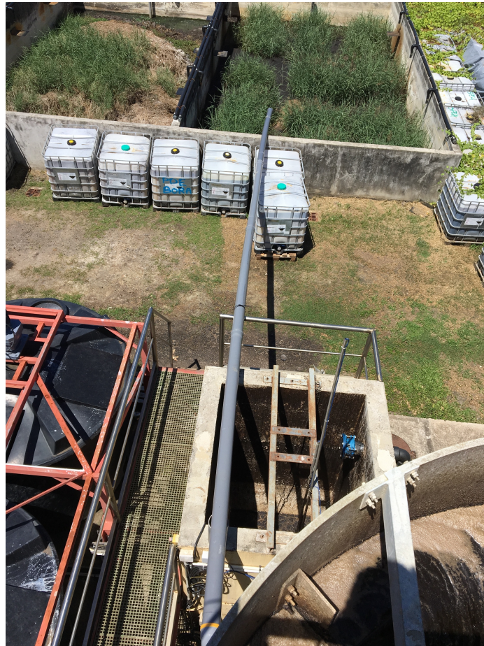
Photo 10: Clarificateur bypassé par la conduite PVC qui débouche directement sur le lit planté de roseaux 3
