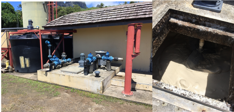
Photo 2: Bâche de dépotage
