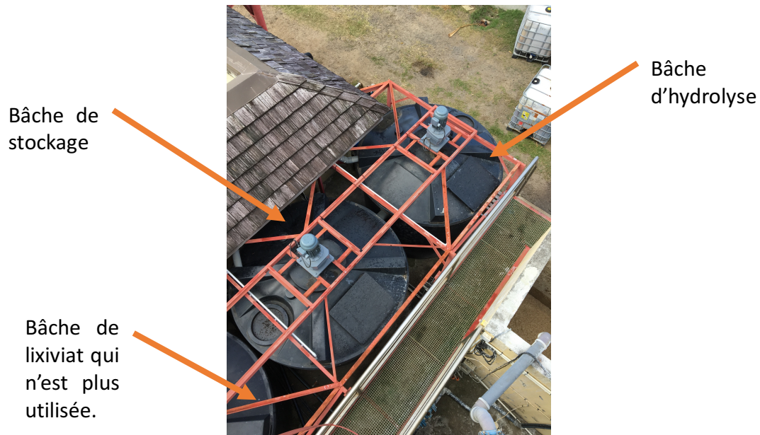
Photo 3: La cuve de gauche est la bâche de stockage et la cuve de droite est la bâche d'hydrolyse
