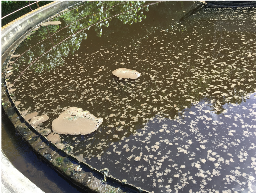
Photo 9: Boue en surface du clarificateur de la station de traitement des eaux usées de Faanui
