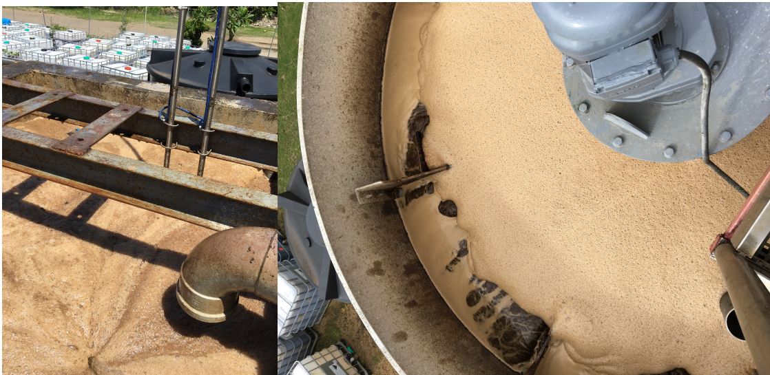
Photo 1: Moussage au niveau de l'épaississeur des boues (photo de gauche) et du réacteur Carbofil (photo de droite)
