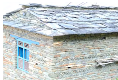
Maçonnerie en pierre et terre comportant un appareillage en arête de poisson et un chaînage d'angle.
