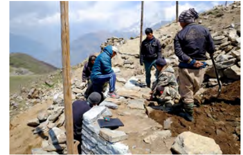
Visite du chantier par les membres de LCDM lors de la réalisation des murs de soutènement.
