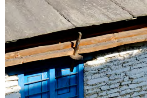
Inclusion en bois dans la maçonnerie permettant la création d'un support extérieur.
