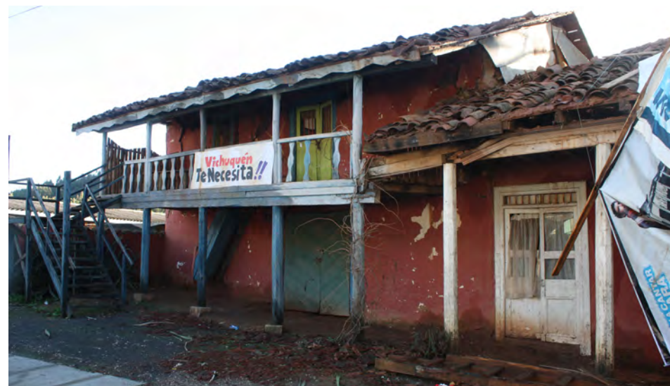
Maison avec des dommages depuis le tremblement de terre de 2010 à Vichuquén. Avec des affiches pour appeler les voisins de Vichuquén pour sauver leur patrimoine.
