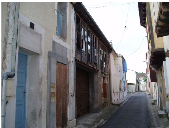
Bâtiment très dégradé, bastide de Villeneuve-sur-Lot, rive gauche source : Raphaël VERA, enquête de terrain (27 mai 2018)
