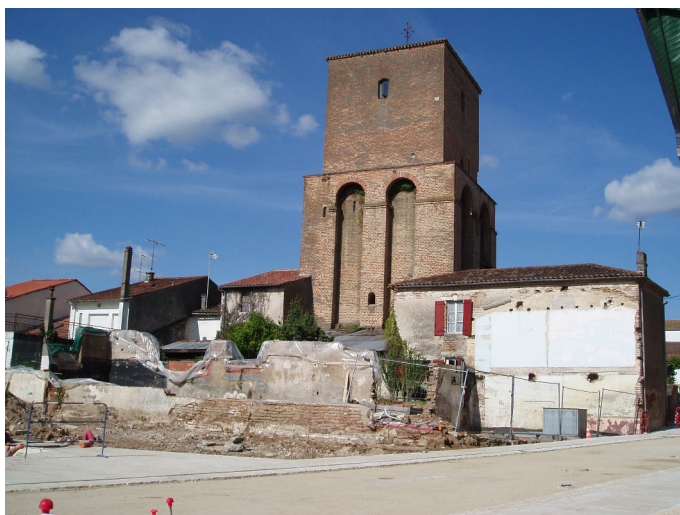
Démolition de garages, place Castelviel, Sainte-Livrade-sur-Lot source : Raphaël VERA, enquête de terrain (27 mai 2018)
