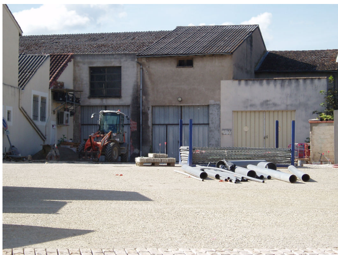
Travaux de rénovation de la place Castelviel, Sainte-Livrade-sur-Lot source : Raphaël VERA, enquête de terrain (1er juin 2018)
