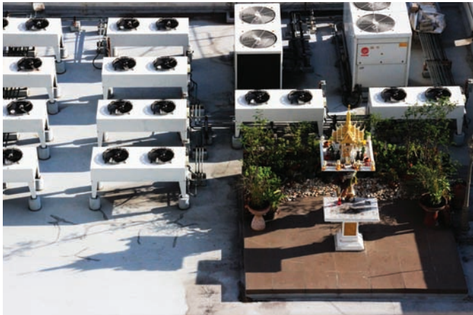
Le 16 août 2017, 12h07 Le temple et ses climatisations Détail du rooftop voisin © Photo personnelle
