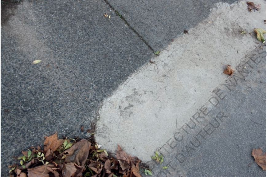
Une galette de béton a été ajoutée pour faire la transition entre le plan incliné et le sol.
