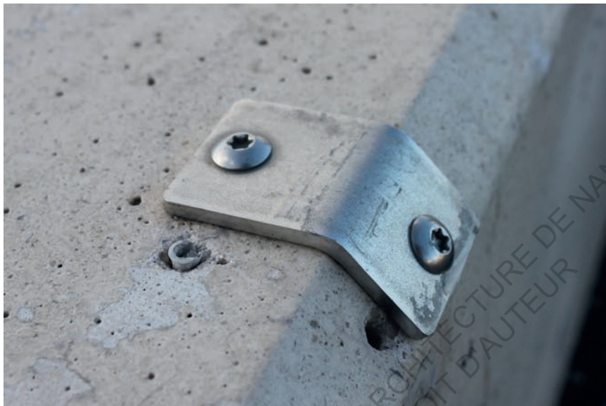
Anti-skates en bas du skatepark quai Doumergue, enlevés puis réinstallés.
