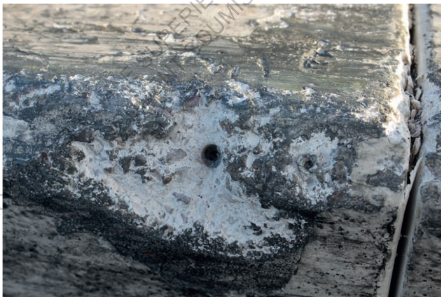
Dégâts suite à l'enlèvement des anti-skates.
