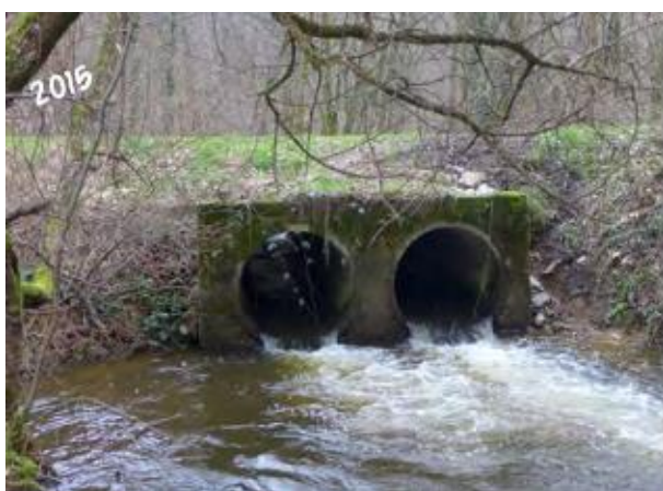
Figure 3 : Passage busée avant restauration en 2015 (source : PNR Péroigord-Limousin, 2017)
