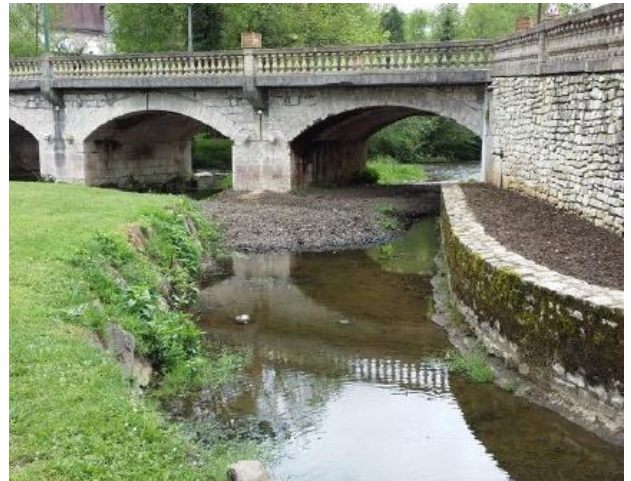
Figure 28 : Bras d'eau avant travaux Source : PNR
