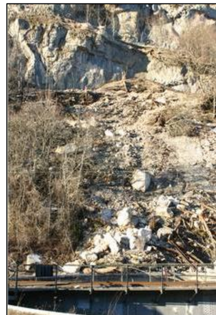
Figure 2 : Exemple d'un éboulement sur la plaque tournante CFF à Vallorbe, Décembre 2010.
