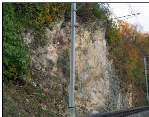
Figure 10 : Rocher de Toveyres, présence d'un treillis métallique plaqué et cloué
