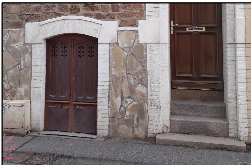
Figure 41 : Logement avec sous-sol, vulnérable face à la submersion marine (cliché : F.Vendrin 2018)
