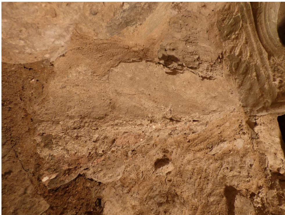
Fig. 34 – Église Saint-Pierre de Lémenc, Chambéry (Savoie), traces d'enduits à l'arrière de l'oculus
