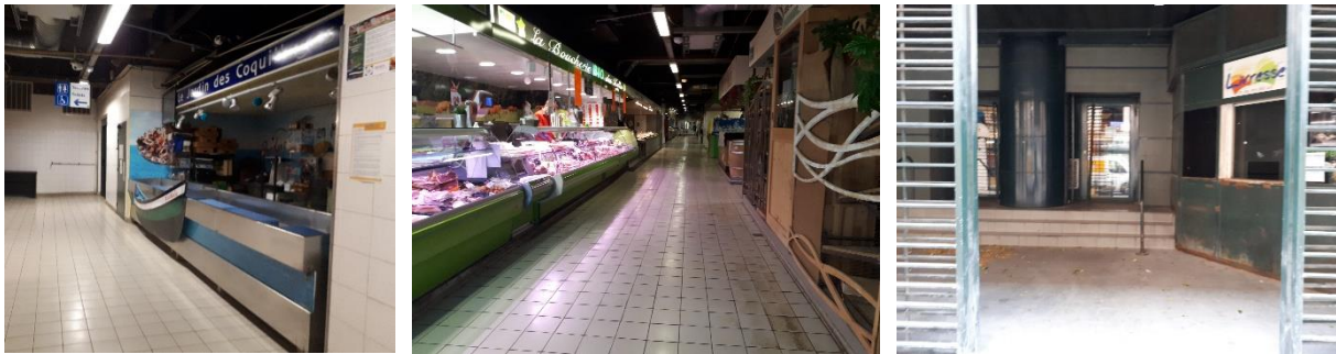
Illustrations 60, 61 et 62 : Eléments dépréciatifs des halles d'Avignon (vétusté des stands, usure des matériaux, vieillissement de la structure)
