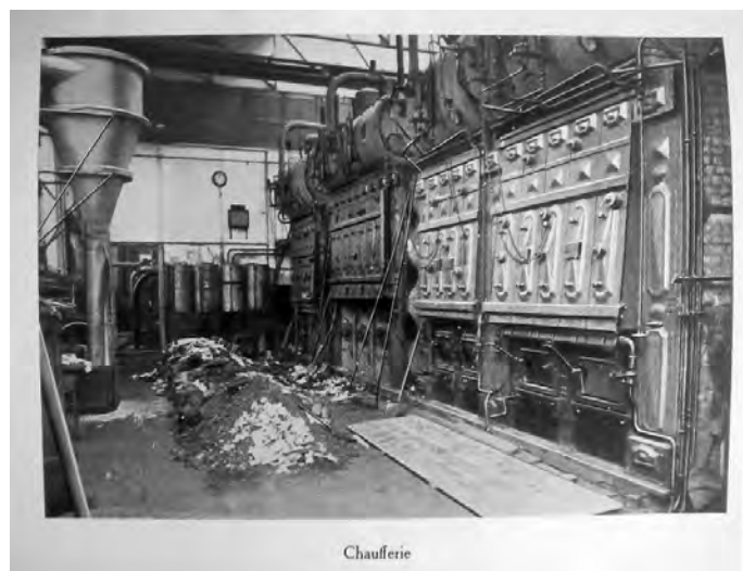
Fig. 30: Photographie de la chaufferie, 1927, Cinémathèque Française, Fonds Louis Gaumont,
