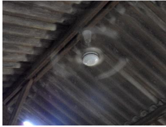
Figure n°27 : Ventilateur installé dans une nurserie (Photographie de l'auteur, 2019)
