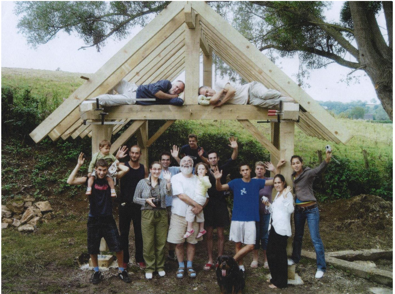
Chantier participatif de restauration d'un Lavoir. Source : Pierre Péré (au centre de l'image)
