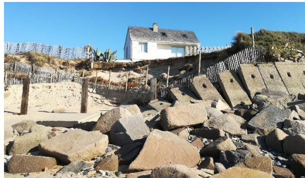
Figure 86 : Photographie des aménagements longitudinaux au niveau du camping Le Grand Large, P. EMILE, 26/02/19
