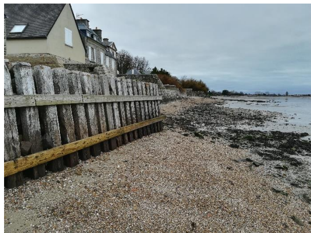
Figure 76 : Photographie de murs protégeant des habitations au Hameau Le Rivage, P. EMILE, 4/01/19
