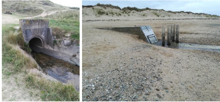
Figure 88 : Photographies du conduit d'eau sous l'estran au hameau Le Pou, P. EMILE, 4/01/219
