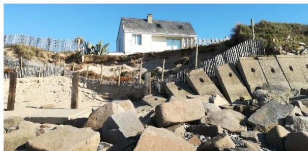
Figure 4 : Photographie d'un enrochement écroulé et de séries de ganivelles devant une maison à Scirotot, P. EMILE, 26/02/19
