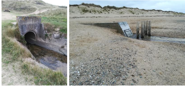
Figure 88 : Photographies du conduit d'eau sous l'estran au hameau Le Pou, P. EMILE, 4/01/219
