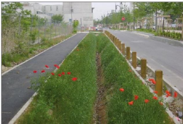
Figure 3 : l'eau pluviale - ressource (exemple de noue d'infiltration)
