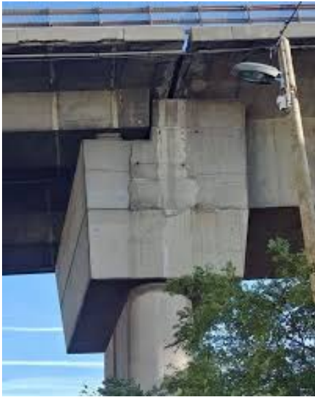
Figure 24 : Dégradation du viaduc autoroutier de Marseille, source : Pierre-Jean Pillonnet
