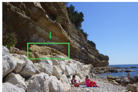
Figure 7 Risque éboulement à Carry-le-Rouet, 2016 (Rapport de stage H.Tepognin, projet VALSE 2012-2015)
