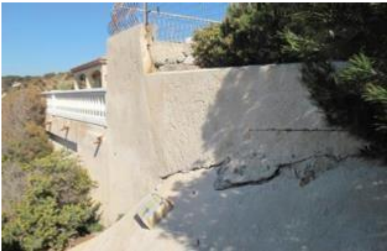
Figure 33 Exemple de parades ayant atteint leurs limites (béton projeté fissuré à gauche sur le sentier du Lézard à Carry-le-Rouet, 2013 (Projet VALSE 2012-2015).
