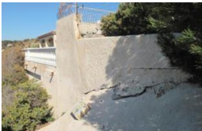
Figure 33 Exemple de parades ayant atteint leurs limites (béton projeté fissuré à gauche sur le sentier du Lézard à Carry-le-Rouet, 2013 (Projet VALSE 2012-2015).
