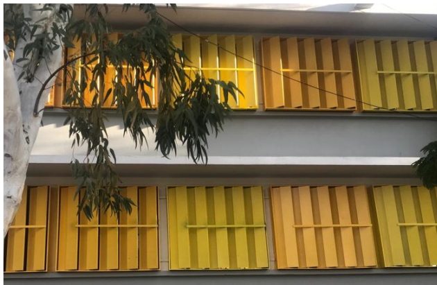
Fig 24 : Pare-soleil en métal limitant la ventilation naturelle Source : Moreau L., 2019
