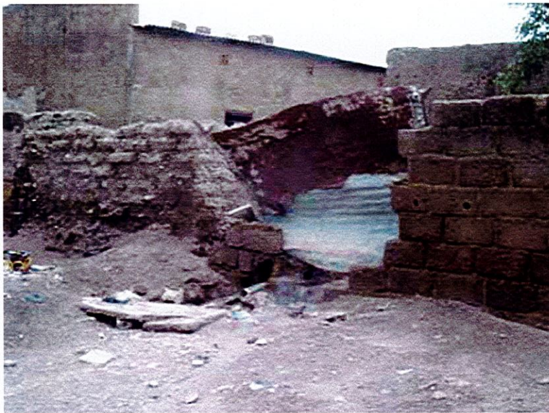
Tuyau d'arrivée des eaux usées d'une propriété sur la rue : absence de caniveau et dégradation de la rue.
