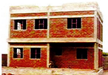
Diébougou Habitat en étage de standing, système mixte BLT en remplissage + ossature Béton
