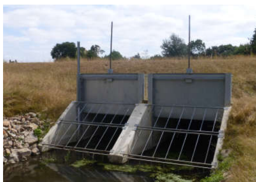
Figure 9 : Ouvrage réalisé sur le site du Tertre (Oudon) par le SBO, mécanisme en crémaillère pour fermer la ZEC. (Source : SBO, 2015)
