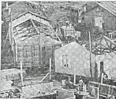
La progression de la construction grâce au recul des cités de baraques.
