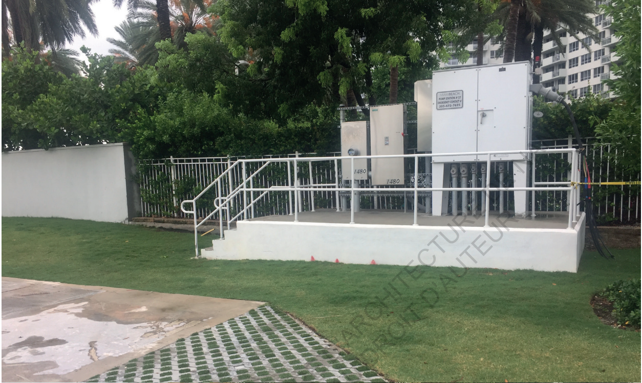
Une des nombreuses pompes de South Beach
