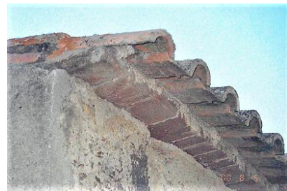
Débordements, les maisons au Portugal.
