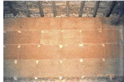
Trous laissés par le coffrage et remplis de mortiers.
