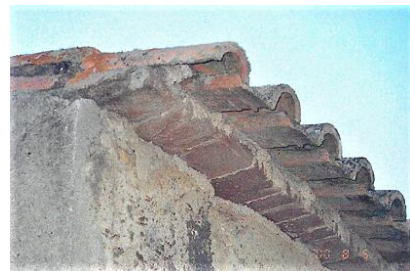
Débordements, les maisons au Portugal.
