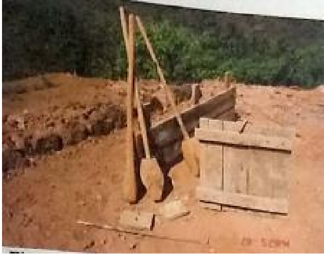
Banche traditionnelle, boulon, entretoise, et outils [Source: Lobo, Earth in Architecture , p.44]
