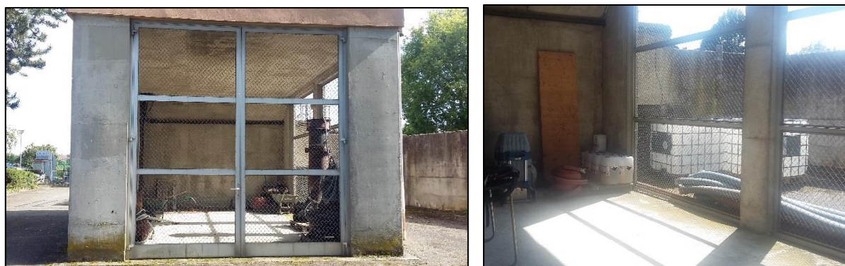
Photo 4 : Local d'accueil du filtre pilote.
