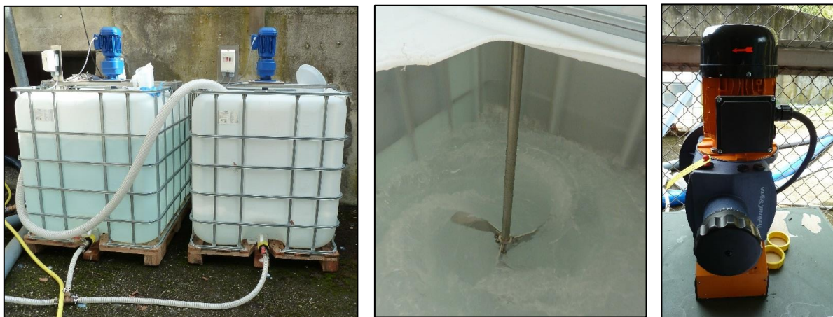
Photo 11 : Cuves de préparation du floculant munies d'agitateur et pompe doseuse
