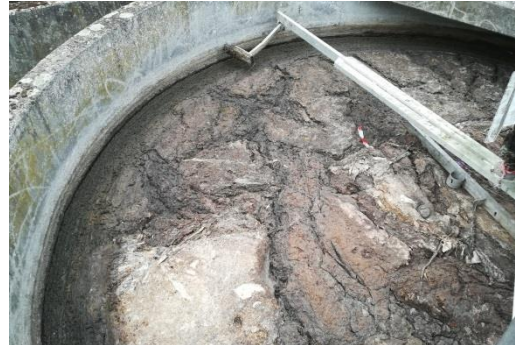
Photo 42 : Dégraisseur-dessableur de la station de pompage d'Horbourg-Wihr.
