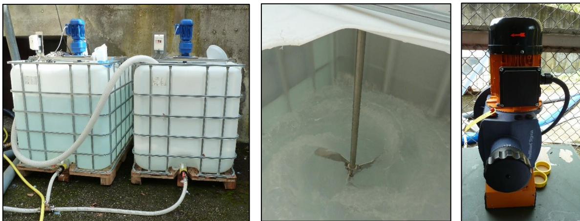
Photo 11 : Cuves de préparation du flocculant munies d'agitateur et pompe doseuse
