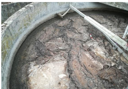
Photo 42 : Dégraisseur-dessableur de la station de pompage d'Horbourg-Wihr.
