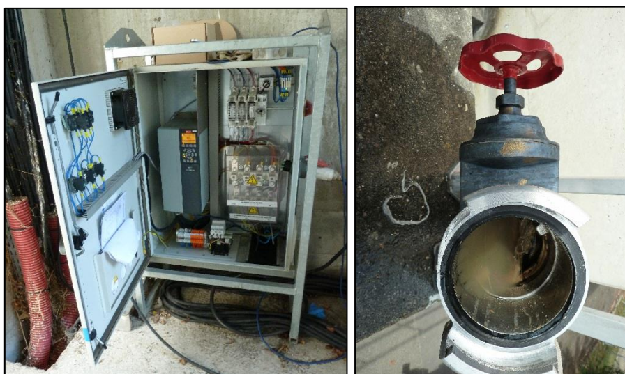
Photo 6 : Armoire électrique avec variateur de fréquence et vanne de régulation située après la pompe d'alimentation
