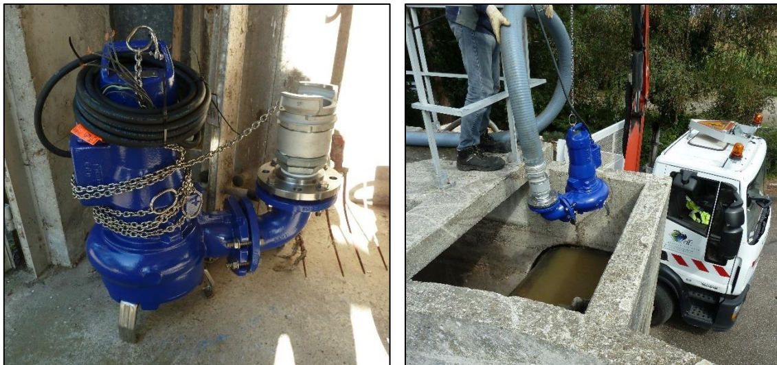
Photo 5 : Pompe d'alimentation et son installation dans l'ouvrage en sortie de dégraisseur.
