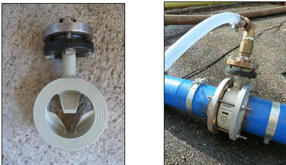
Photo 10 : Mélangeur statique et injection du coagulant au niveau du mélangeur statique
