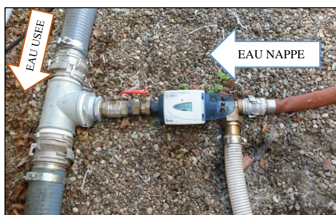
Photo 8 : Connexion de l'eau de la nappe à l'installation pilote
