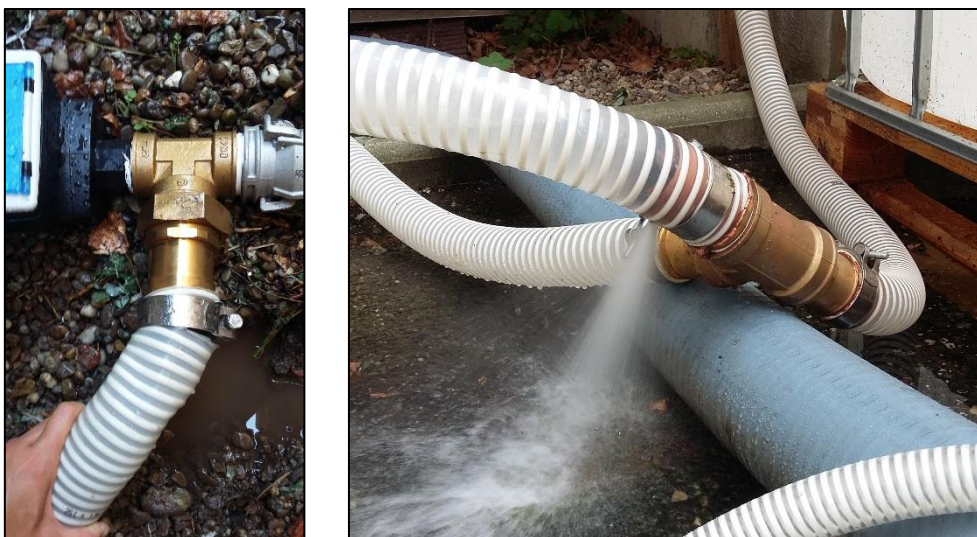
Photo 41 : Casse et fuite au niveau de l'installation pilote
