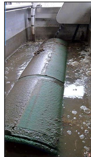
Photo 16 : Tambour lors d'un cycle de lavage
