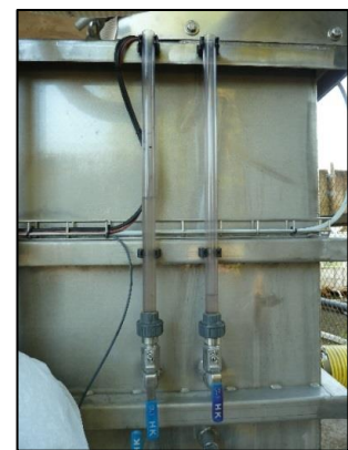
Photo 15 : Tubes de niveau, niveau de l'eau à filtrer (g.) et de l'eau filtrée (d.)
