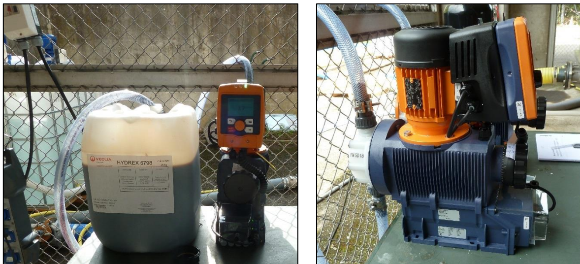
Photo 9 : Bidon de coagulant biosourcé associé au poste de dosage et pompe d'injection
