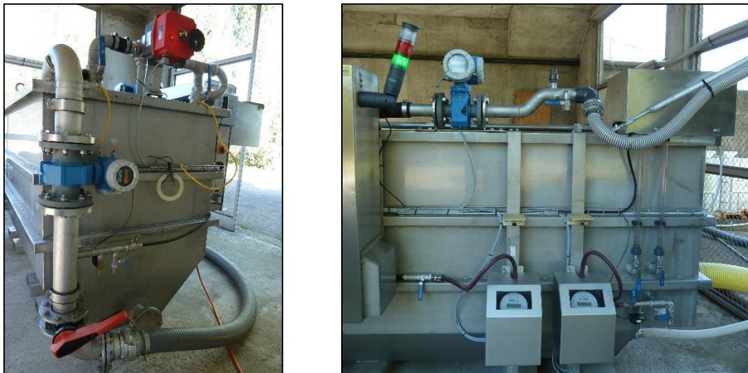
Photo 18 : Débitmètres et turbidimètres installés sur le filtre pilote.
