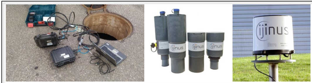
Figure 27 : Installation d'un capteur MainFLO, sondes US Ijinus et pluviomètre Ijinus (de gauche à droite)
