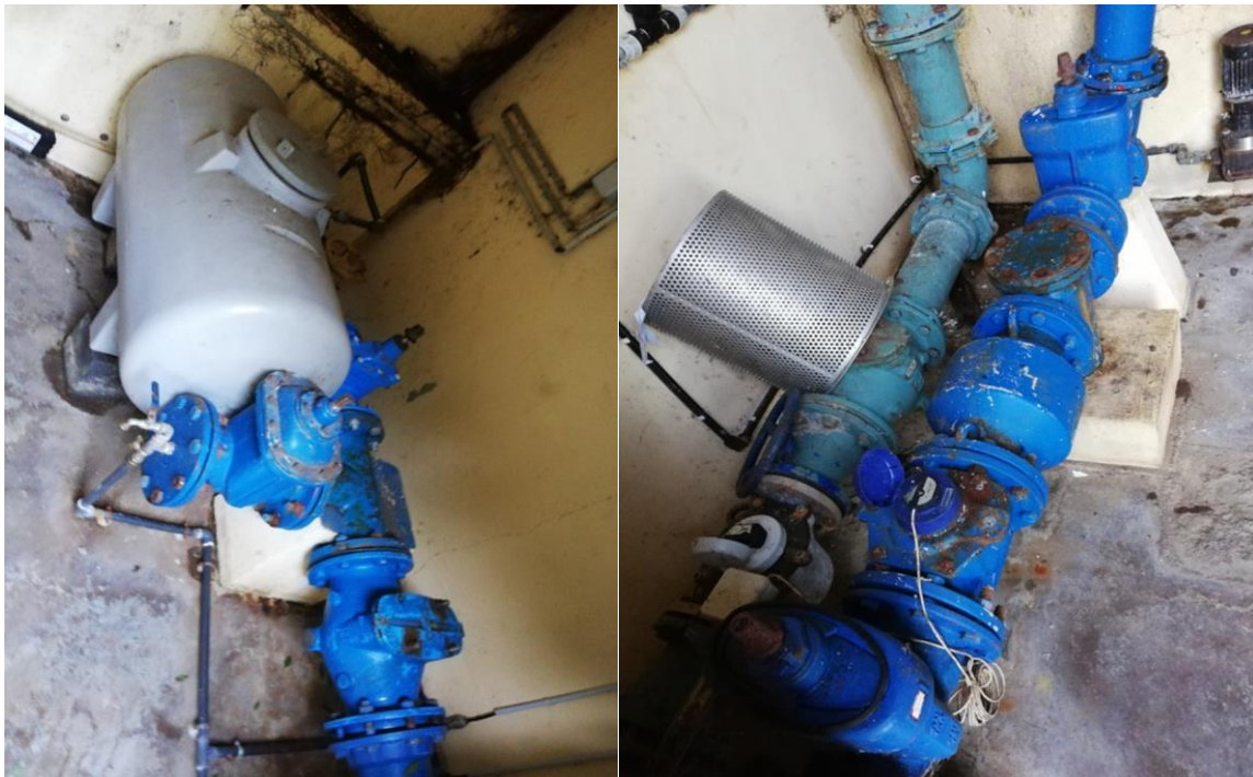
Figure 8 : Chambre des vannes du réservoir Maduran
