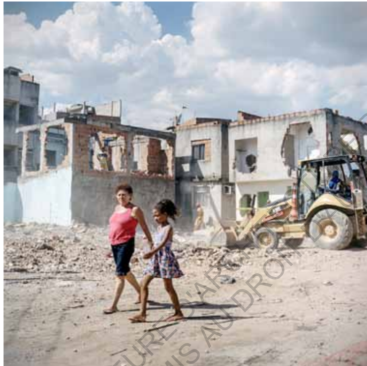
Destruction d'une favela Source : http://www.huckmagazine.com/
