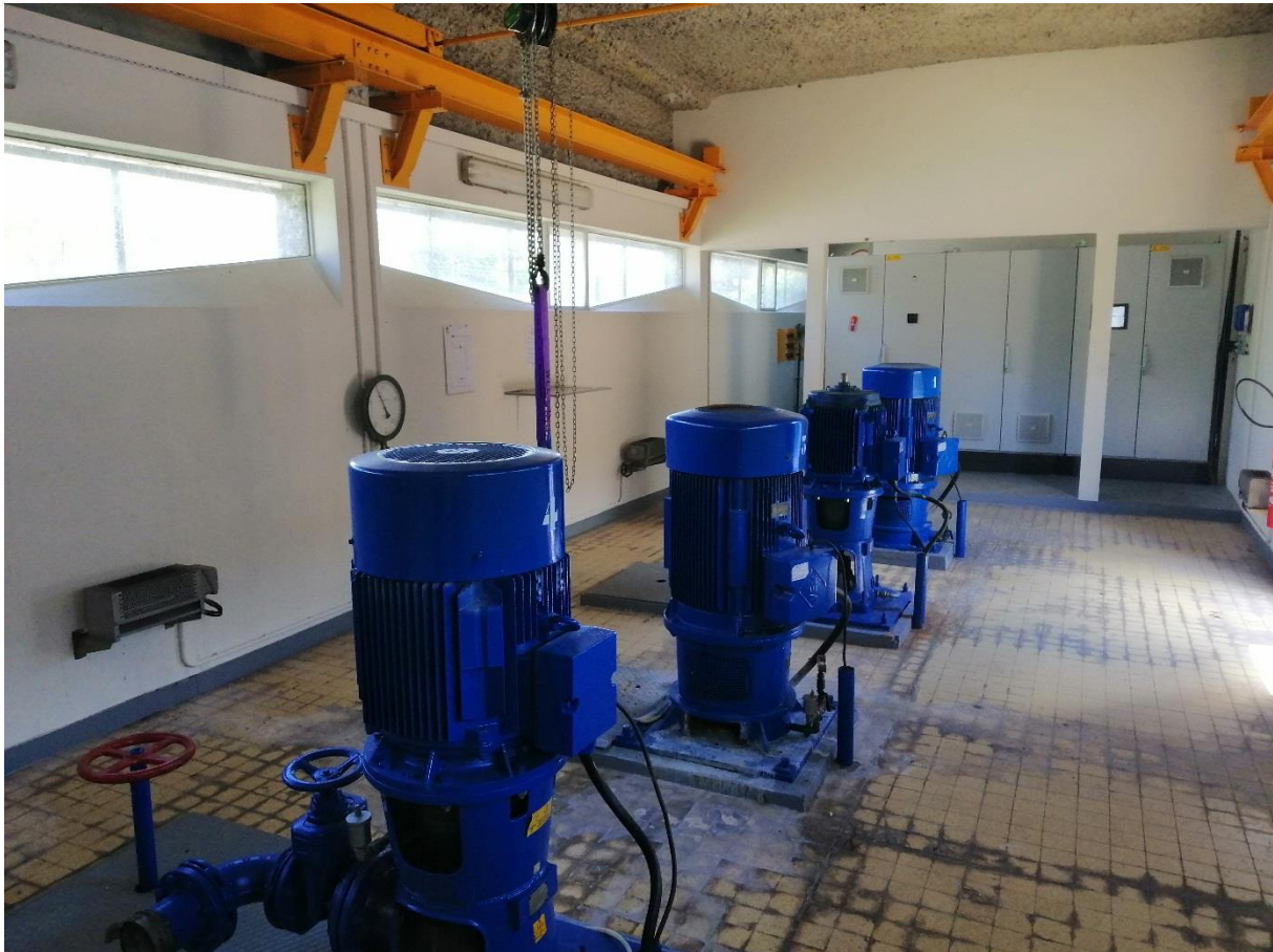
Figure 9: Station de pompage de l'usine de Chenove
