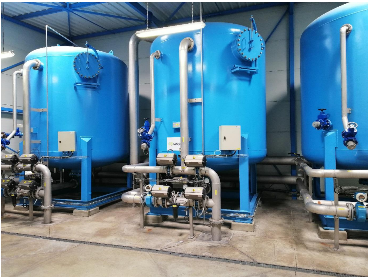
Figure 6: Filtres à charbon à l'usine de Marsannay
