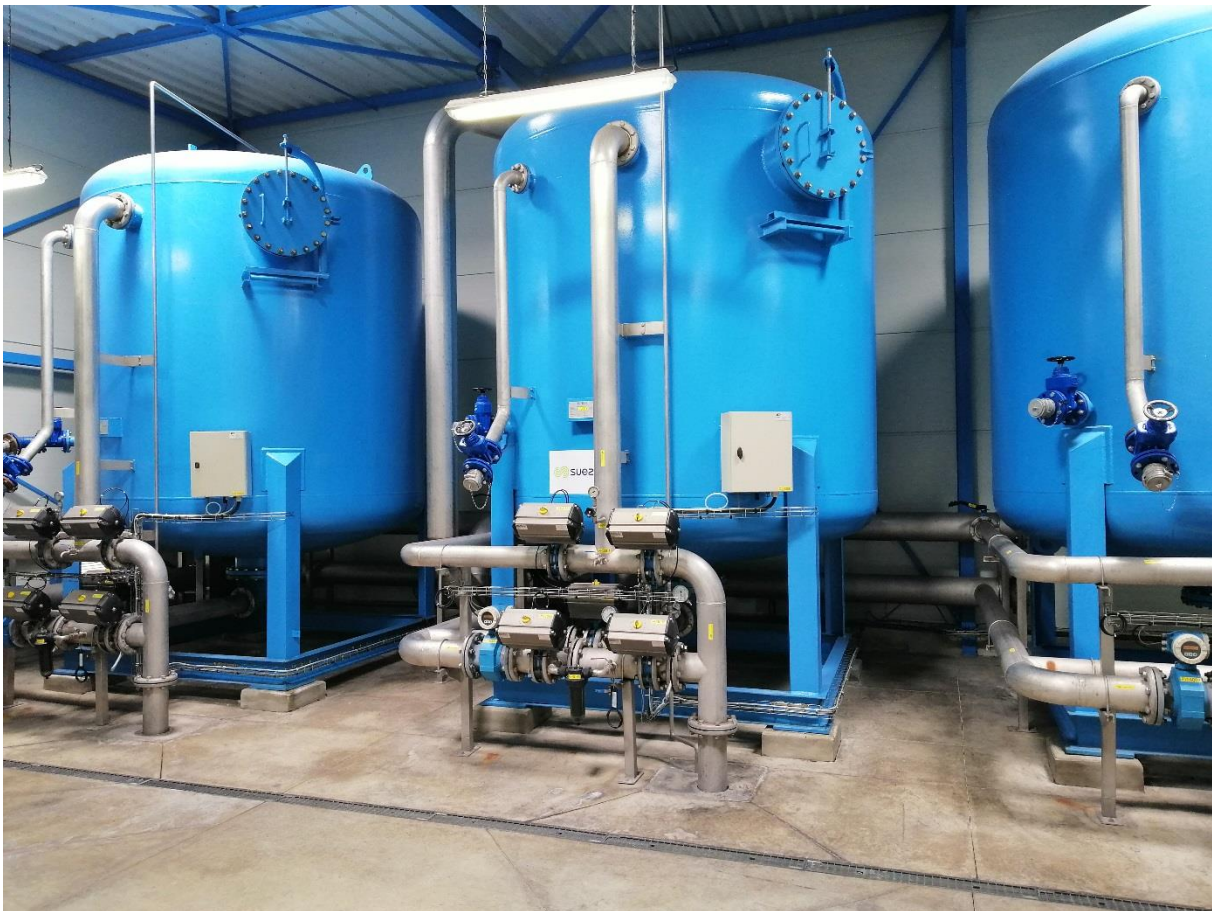
Figure 6: Filtres à charbon à l'usine de Marsannay
