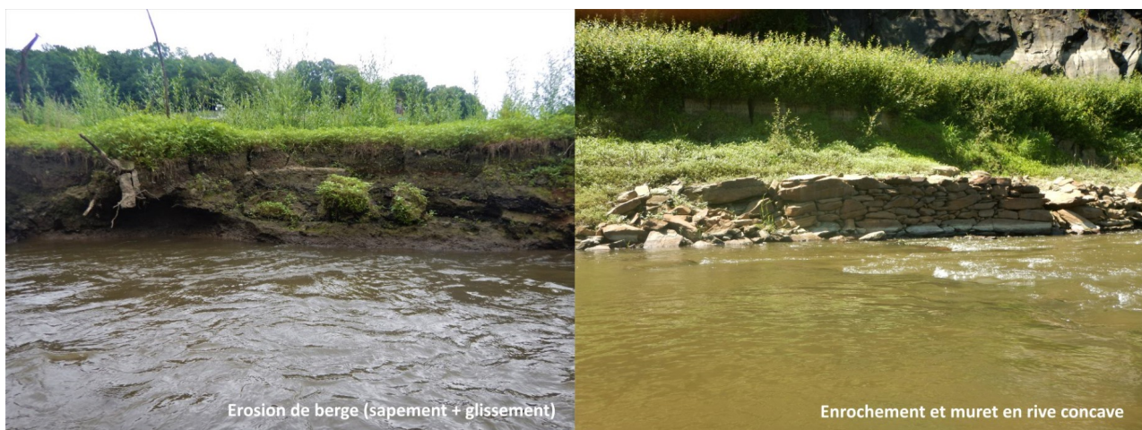
Figure 3.33 : Exemple d'érosion et d'empierrement des berges sur la Sélune (R.Létodot, 2019)
