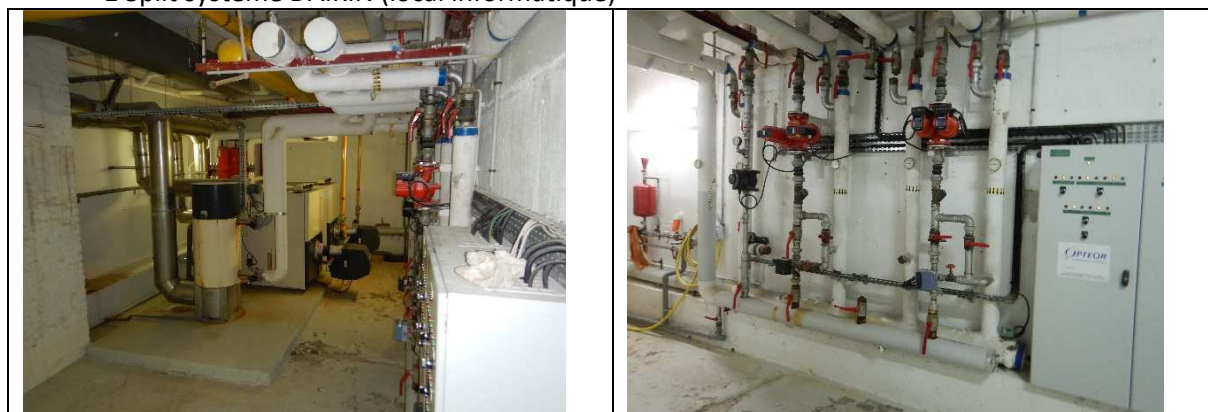
Photographies 22 et 23 – Chaufferie complexe maison des associations
