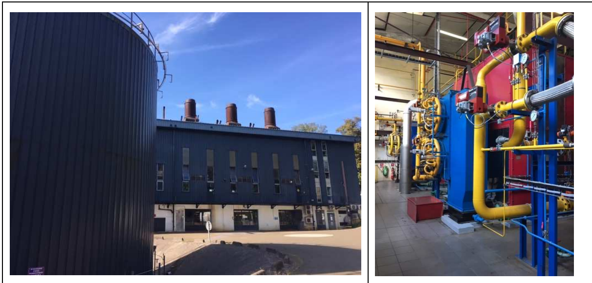
Photographies 01 et 02 - Chaufferie centrale VERSEO
