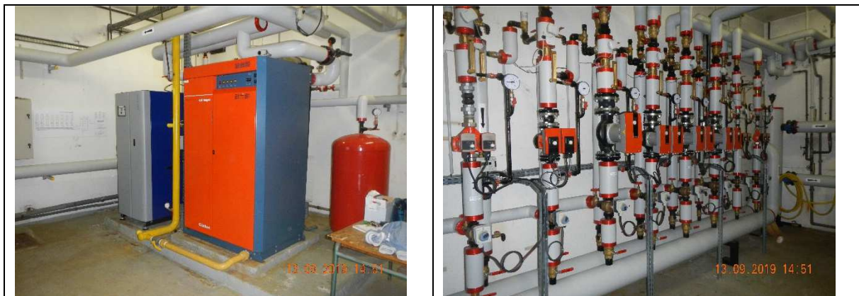
Photographies 20 et 21 – Chaufferie complexe Lully-Vauban
